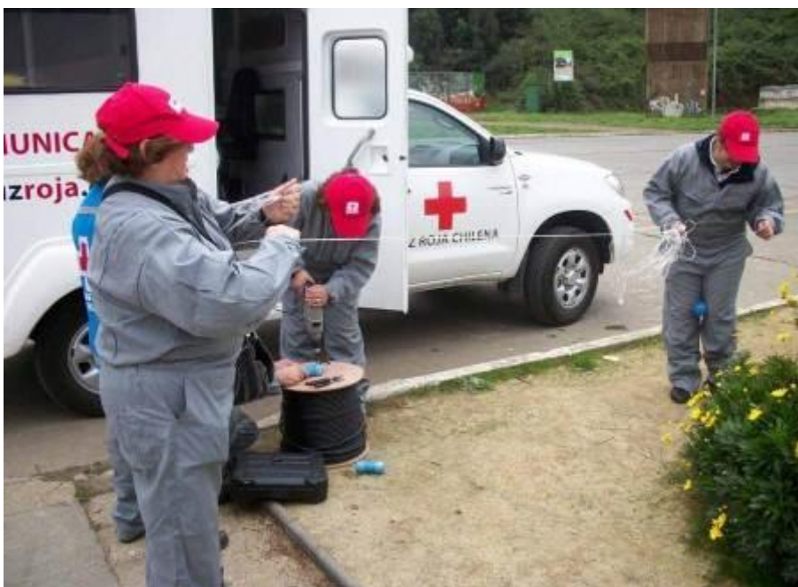
Voluntarios en el curso de telecomunicaciones, realizando las actividades de instalación de equipos en terreno, en la comuna de San Pedro de la Paz, Región del Bío Bío. Fuente: CRCh.
