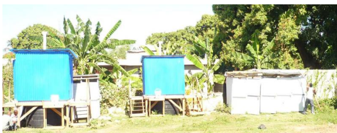
Latrines à réservoir surélevé et douches dans un camp Source: FICR
